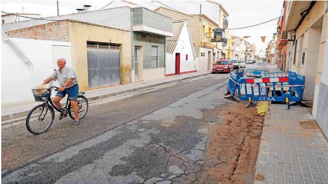
Un vecino circula por la calle de El Palmar afectada por la rotura de las tuberías, este lunes. JESÚS SIGNES
